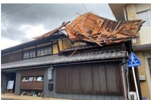
⑪突風被害 (八百津町)
