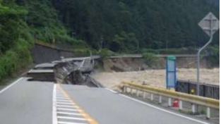
⑦路面陥没 (下呂市・国道41号)
