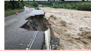
①路側決壊 (高山市・国道471号)
