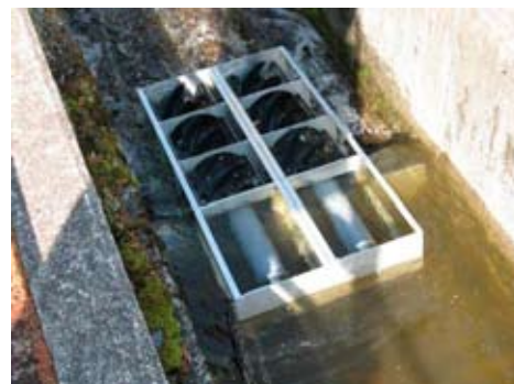
農業用水に設置された「らせん式小水力発電施設」
