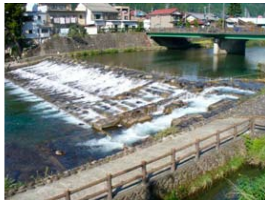
河川魚道（郡上市 吉田川（島谷用水堰））
