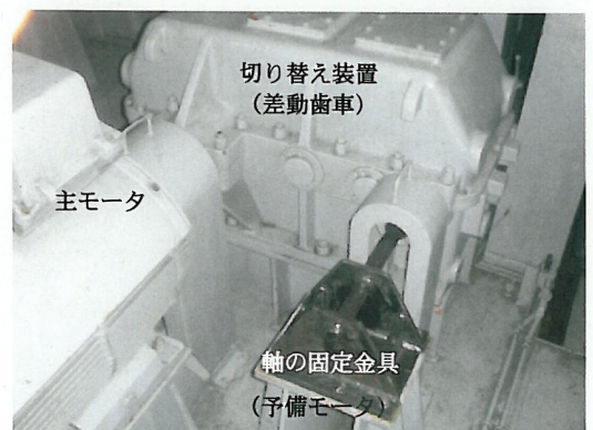
(調節ゲート開閉装置全景)
