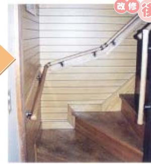
階段登り口に縦手すり。曲がり部分は連続した手すりを設置。
