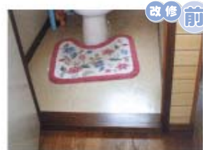
トイレの入口に段差(敷居)有り。
