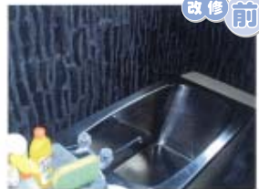
浴槽と洗い場との隙間がある。
