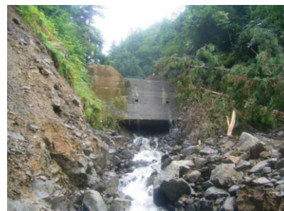
えん堤の底抜け
