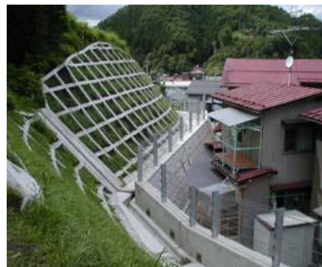
がけの崩壊を防止する施設及び人家の被害を防止する施設の例
