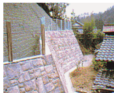
落石による人家の被害を防止する施設
