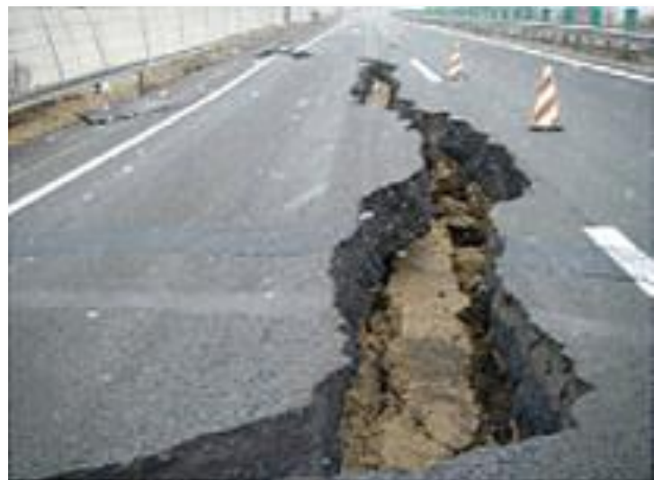
東北自動車道(福島飯坂IC～国見IC) 路面が大きくひび割れている
