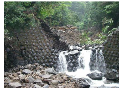
えん堤の欠損
