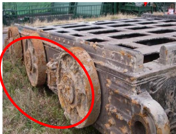
錆びが発生している樋門のローラー部分 (ゲートを円滑に上下させるために必要な部品)
