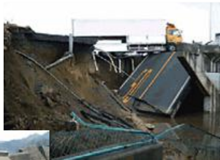
宮城県道 石巻女川線(日和大橋) 土構造部の崩落と共に落橋している
