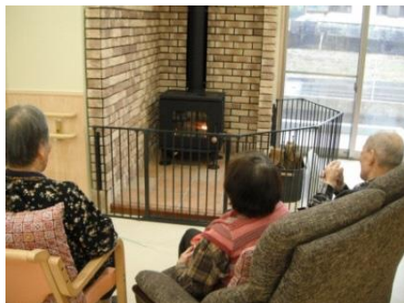
福祉施設に導入した薪ストーブ
