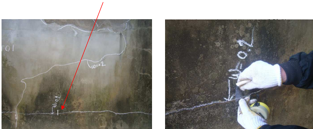
写真 2.2-2 ひび割れの監視状況
