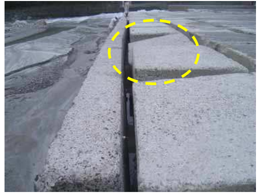
護床ブロックに生じた沈下
