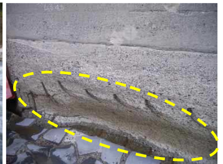
堰柱に生じた鉄筋露出と摩耗
