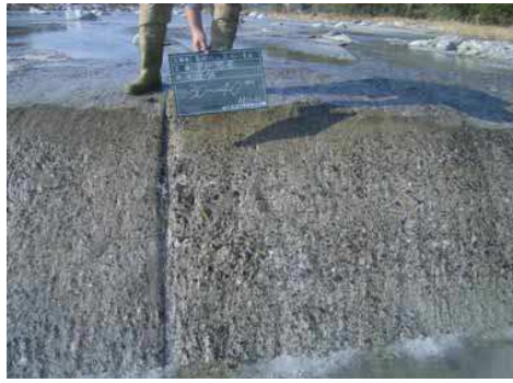
堰体に生じた摩耗
