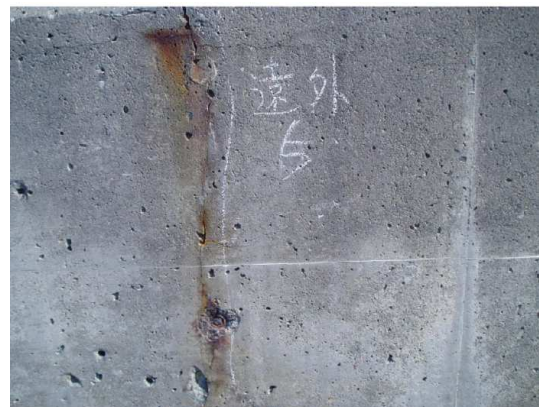
写真 2.2-4 ひび割れ部の錆汁
