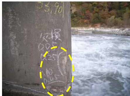
堰柱に生じた欠損
