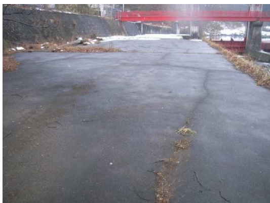
写真 2.2-8 護岸工周辺地盤のひび割れ
