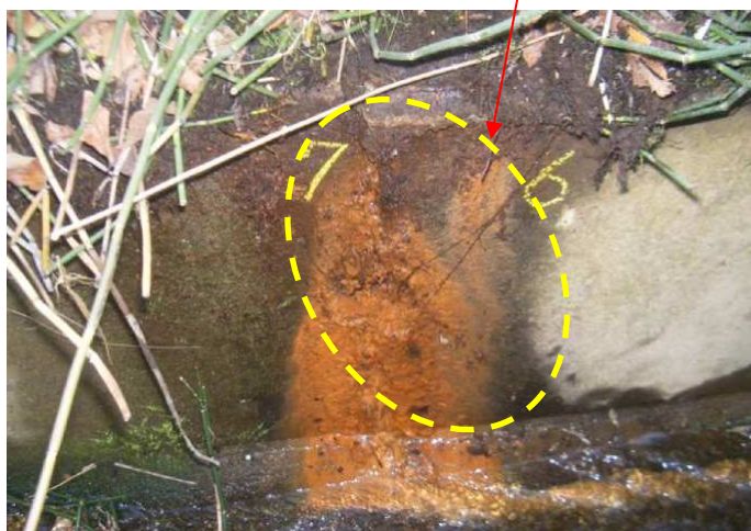
写真 2.2-5 ひび割れからの漏水（滲出しの例）
